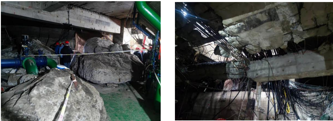
图9 3号机组蜗壳外部混凝土破坏
